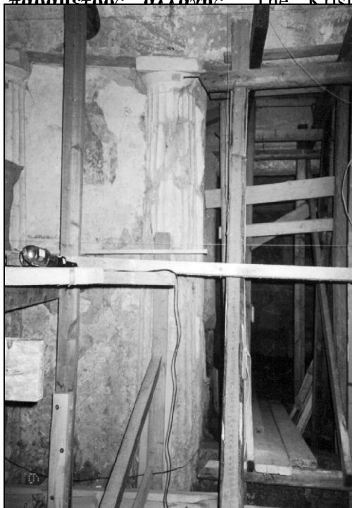
Figure Σφάλμα! Άγνωστη παράμετρος αλλαγής.. The facade of the Krisis Tomb presents significant damages
